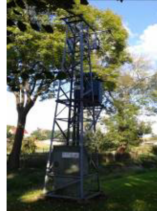
Obr. 5.2.6 Zlonický potok pohled na sloup VN 0,4 kV nacházející se na levém břehu pod mostem C-M1_ZL, ř. km 13,6.
