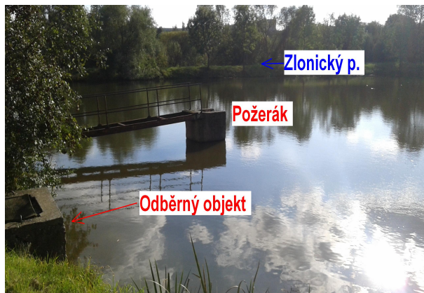
Obr. 5.2.11 Betonový požerák s dvojitou dlužovou stěnou a odběrný objekt do čerpací stanice.
