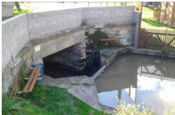
Obr. 5.2.31 Skalský potok, most C-M5_SK, hlásný profil kategorie „C“ v ř. km 0,61. Pohled z levého břehu na vtokové čelo mostu.
